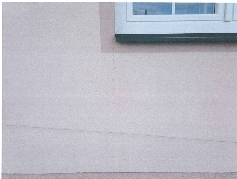
Praskliny v omítce fasády
