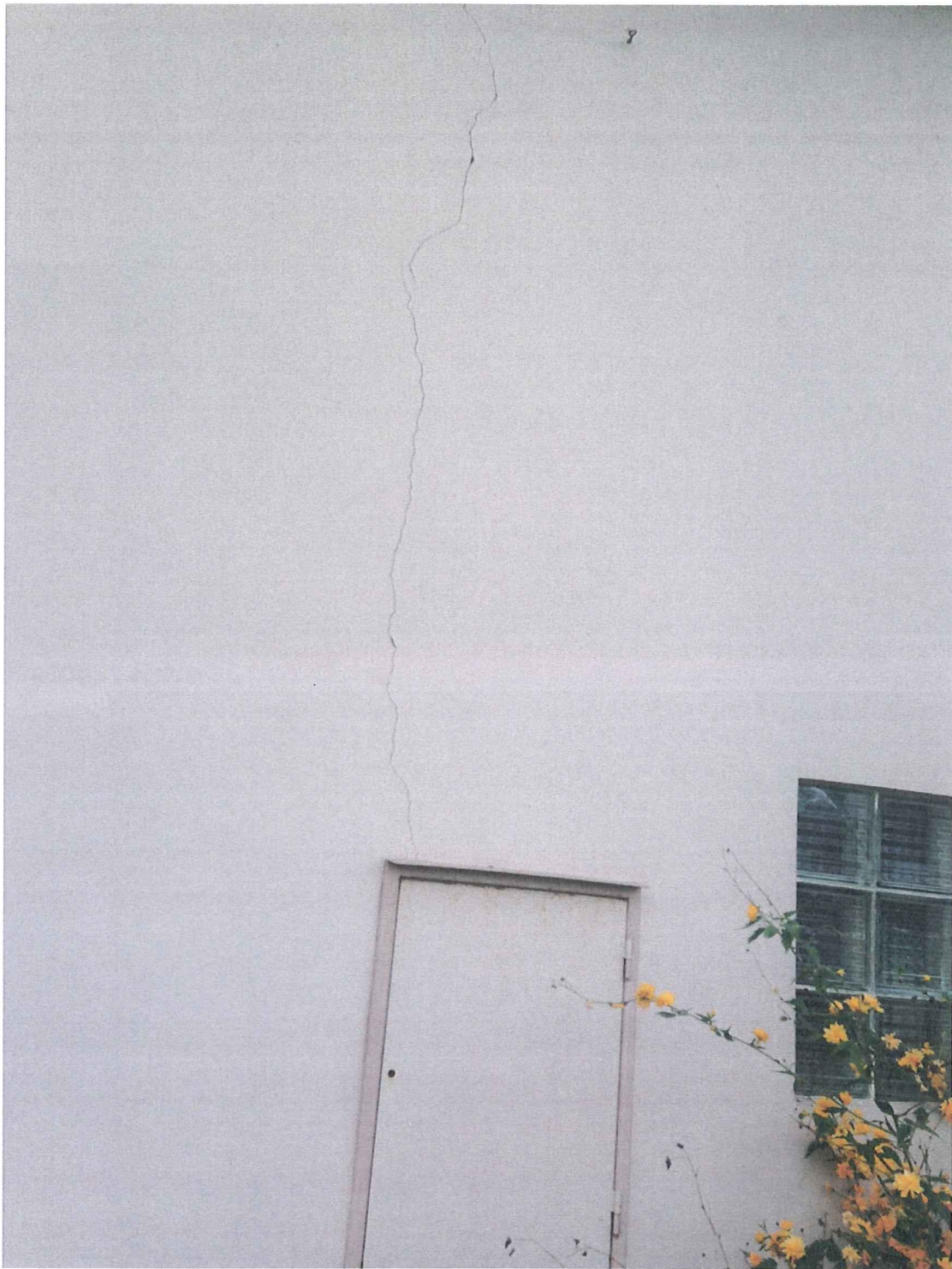
” Prasklina v omítce na rozhraní podsklepení a nepodsklepení
