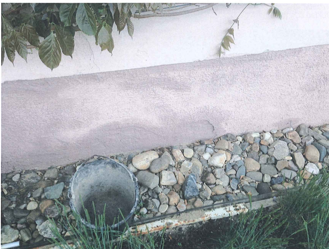
Místní poškození omítky od odstříkující vody od okapového chodníku
