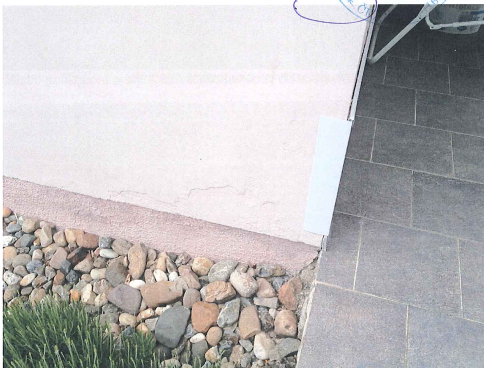
Místní poškození omítky od odstříkující vody od okapového chodníku
