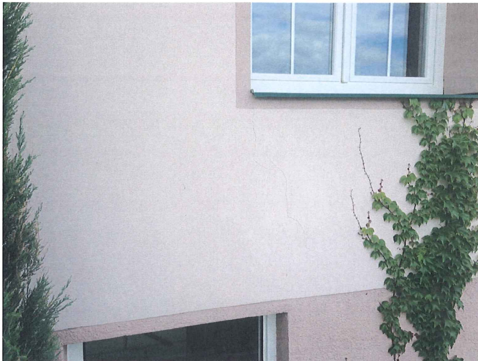
Praskliny v omítce fasády
